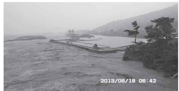
完成直前の洪水被害
