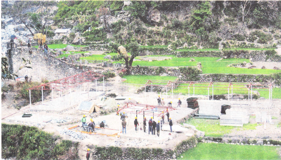
小水力発電所改良工事の一環として建設している作業員用宿舎 ニネパール西部のパジャン郡
