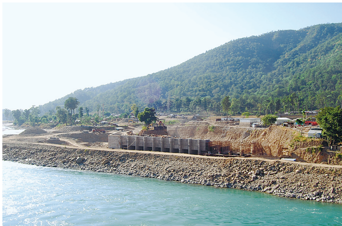
カルナリ川とタライ平原の出合で施工中の灌漑取水口
