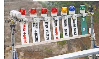
警報システム・避難所は各工事現場に設置
