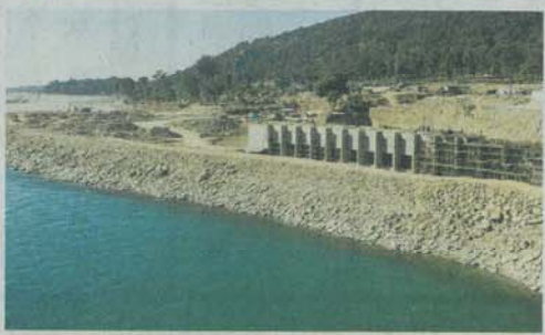
ネパールのカルナリ川で進むかんがい工事の現場。2012年12月(丸新志建設提供)
